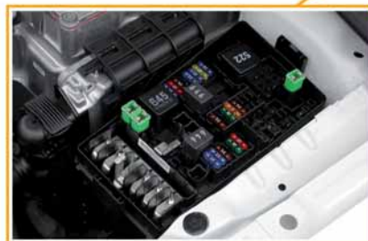
E-Box mit Relais- und Sicherungshalter SB und Multifuse-Sicherungshalter SA im Motorraum neben der Leistungs- und Steuerelektronik JX1.
